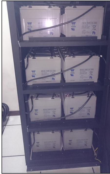
(圖十四)、 75 KVA-UPS 不斷電系統電池箱
