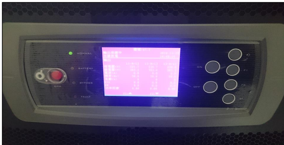
(圖十三)、 75 KVA-UPS 不斷電系統
